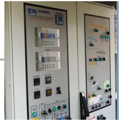
Quadro di comando e automazione con controllo manuale e automatico Control panel and automation with manual and automatic management
